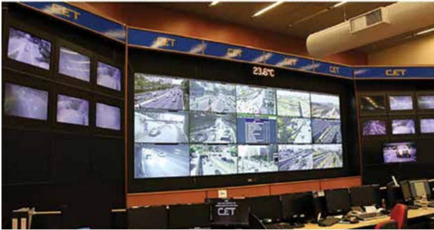
CET Operational Control Center
