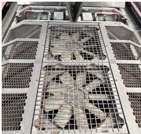
Aparelho de ar-condicionado
